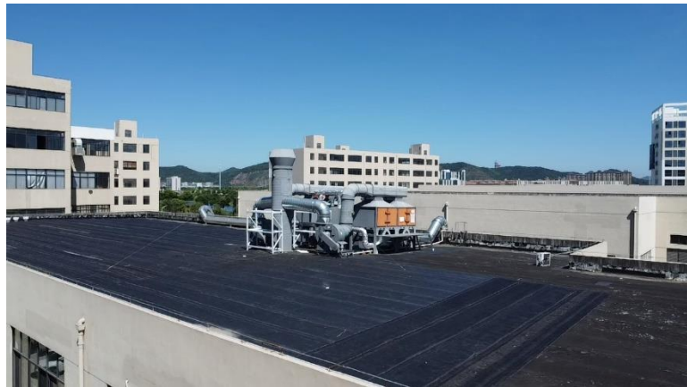
图 3-2 废气处理设施现状
